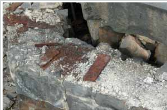
6. OKTOBER 2008 Rostige Eisenkeile erweisen sich bei der Probeöffnung als eine der Ursachen für Verschiebungen der Granitplatten.
