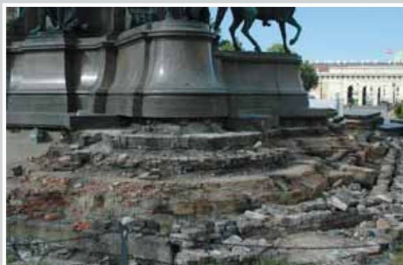
3. JUNI 2009 Das zerrüttete Ziegelfundament des Maria Theresien Denkmals: die Ziegel zerbrochen, der Mörtel zum Teil aufgelöst.
